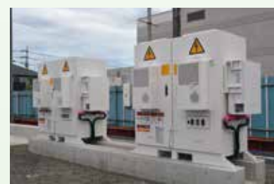
平面駐車場に設置された蓄電池
