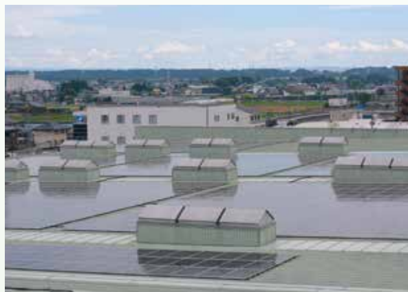
ベルモール所有の東側建物(ケースデンキ)に設置された太陽光パネル
